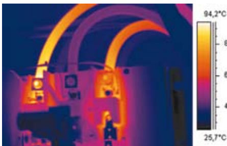
Mala conexión y daños internos.
